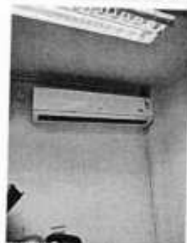
necessário trocar os split 1de 18000 btus e 22000 btus da sala do morge não estão dando vazão devido muito tempo de uso a condensadora e de uma marca o aparelho e de outra estão muito ruim
