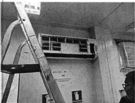
cozinha manutenção preventiva máquina completamente suja
