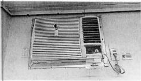
APARELHO DA SALA PEDIÁTRICA (AGUARDANDO O CAPACITOR )
