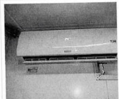
Agratto 30 mil BTU com defeito na placa receptora necessario compra uma placa universal
