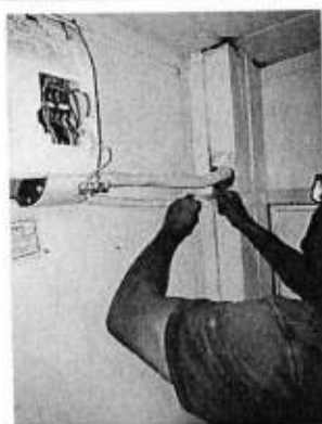
desentupimento e insolamento com fita PVC e limpeza preventiva Sprinter local corredor sala amarela
