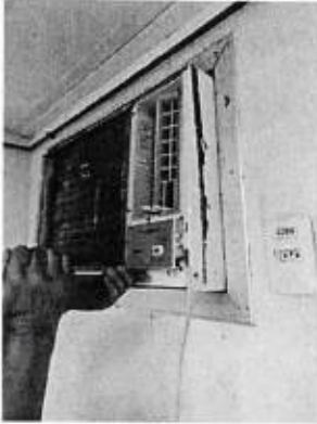
DESMONTANDO A PEÇA PARA COLOCAR O CAPACITOR NO LUGAR.
