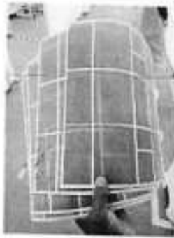
Filtro retirado para Higienização
