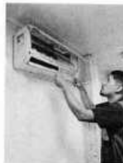
Filtro higienizado e funcionando
