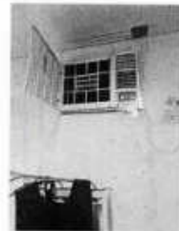
Filtro retirado para Higienização
