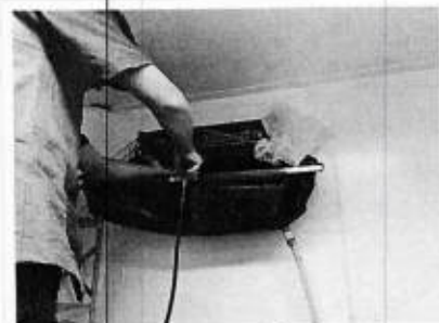
Máquina encontra em má funcionamento, foi feita a limpeza pesada!! Aparelho se encontra funcionando perfeitamente
