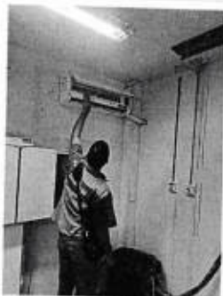
Split - funcionando normalmente
